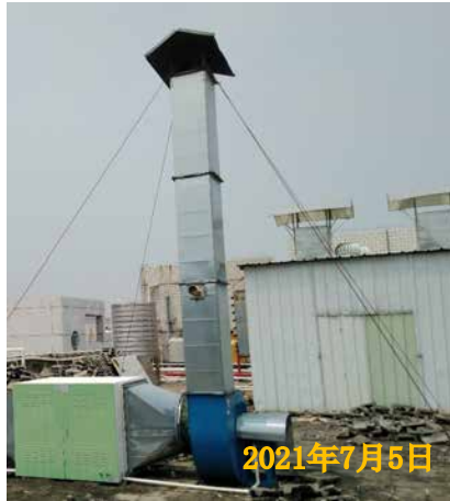
废气处理后采样口
