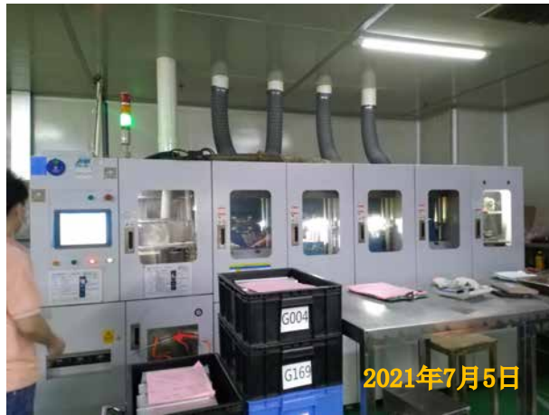
废气收集装置
